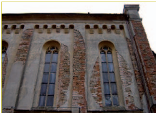
Kostel Čáslav - stav fasády před opravou
